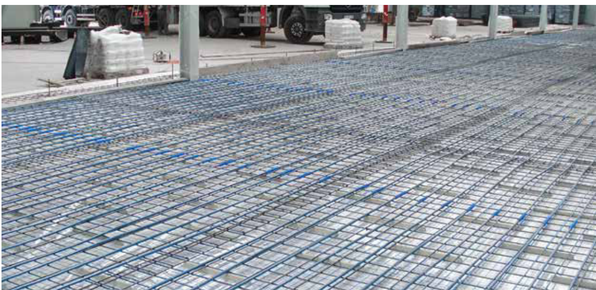
Slika 4. Instalacija podnog grijanja u industrijskom objektu, korištenjem bluePERT cijevi i KAN-therm NET sistema.
