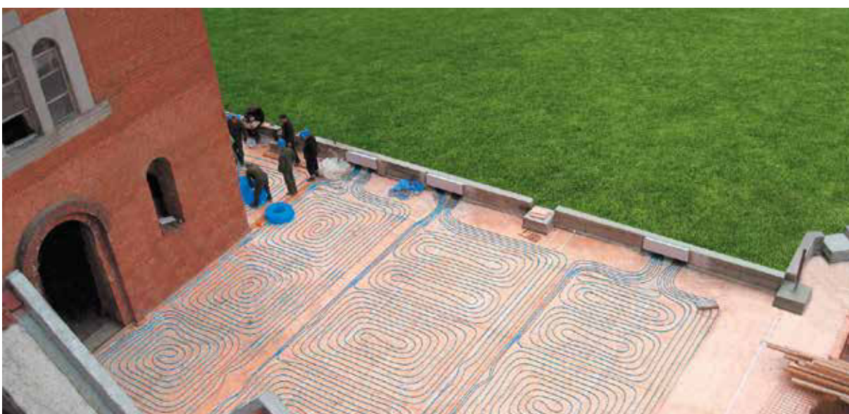
Slika 5. Instalacija grijanja vanjske terase korištenjem bluePERT cijevi KAN-therm sistema.
