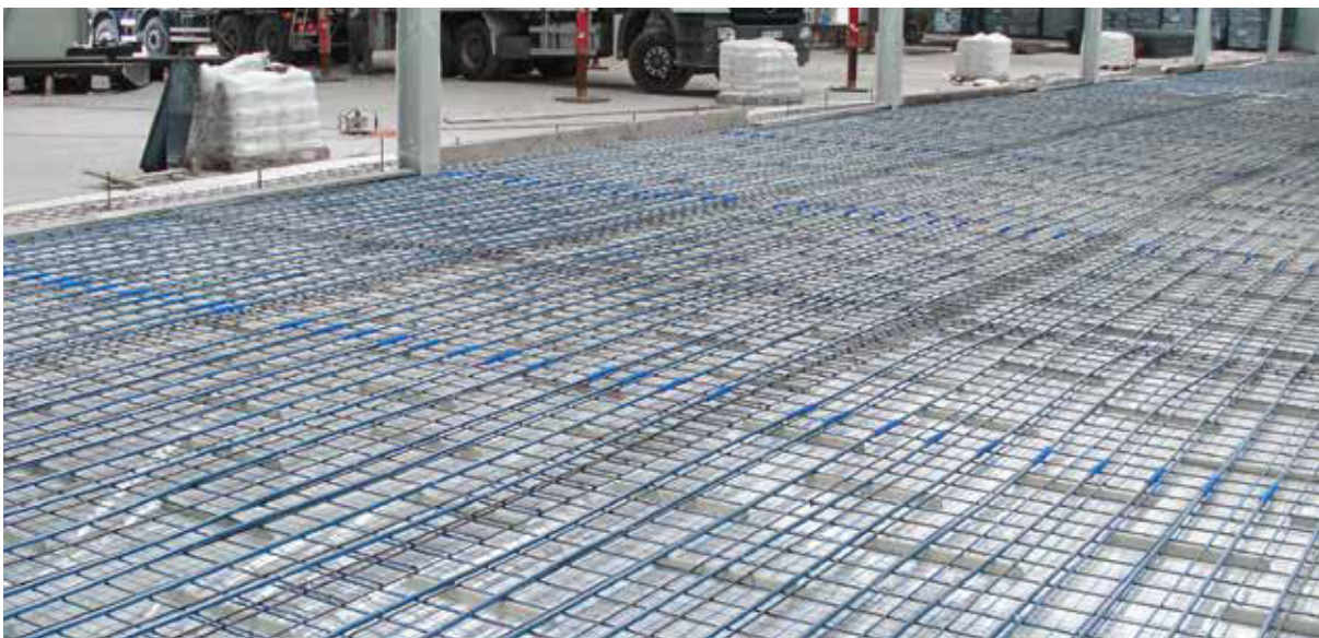
Slika 4. Instalacija podnog grijanja u industrijskom objektu, korištenjem bluePERT cijevi i KAN-therm NET sistema.
